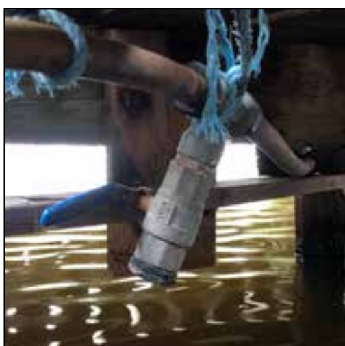
V22. Avtappning. Under däck vid mastskjulet.
